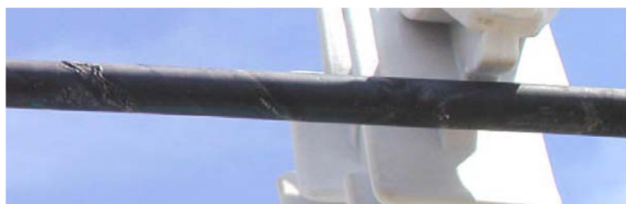
Figura 2.15 - Trilhamento elétrico no condutor coberto.
